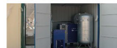
Pumping station for compressed air. Estación de bombeo para aire comprimido.
