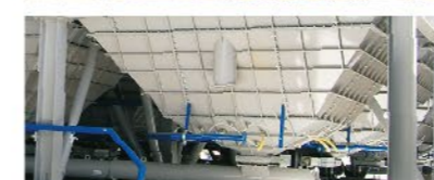
Detail of air slide aeration system. Detalle de sistema de aireación mediante aerodeslizadores
