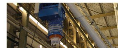
Detail of loading point tank lorries. Detalle de carga de camiones mediante manga retráctil.
