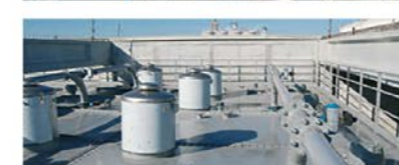
Silo safety equipment. Equipo de seguridad del silo.
