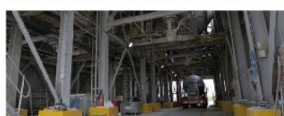
Gantry structure for vehicles transiting. Estructura de paso debajo del silo para tránsito de vehículos.
