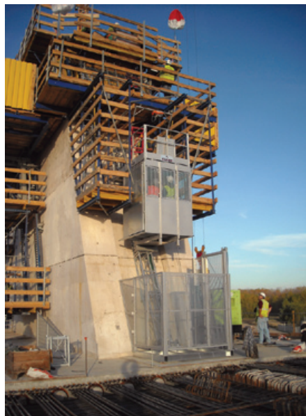
Elevador inclinado Inclined elevator
